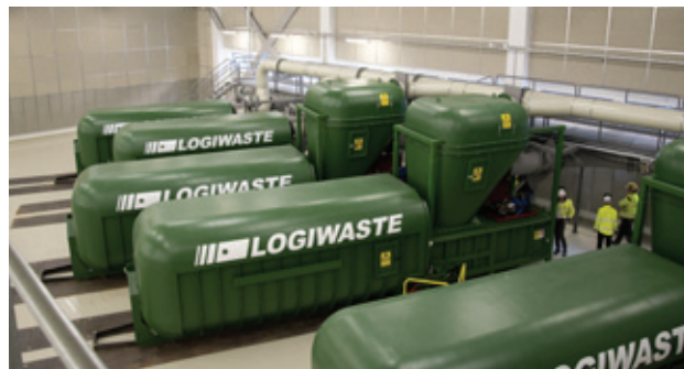
Terminalen på Karolinska sjukhuset i Stockholm. Uppsamling av fyra fraktioner avfall i filtercontainers och kompressorcontainers.
