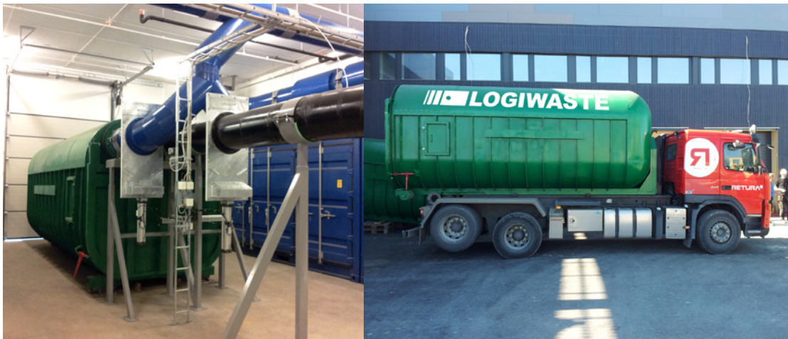
Ovan till vänster: Terminalbyggnad med container. Källsortering stöds genom att respektive avfallsfraktion automatiskt fördelas till rätt container. Ovan till höger: Hämtning av full avfallscontainer. Containern lyfts upp på lastväxlarbil.
